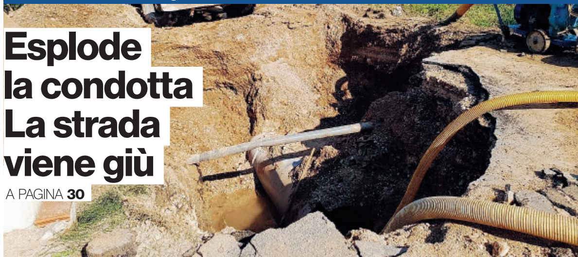
La voragine che si è aperta su via della Rinchiusa
